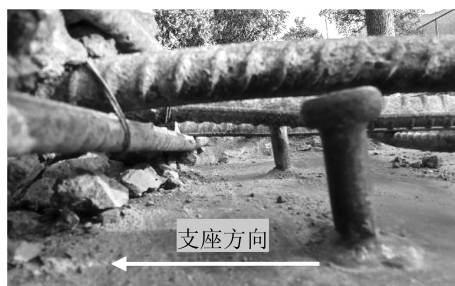
图 10 钢板上方栓钉变形图
